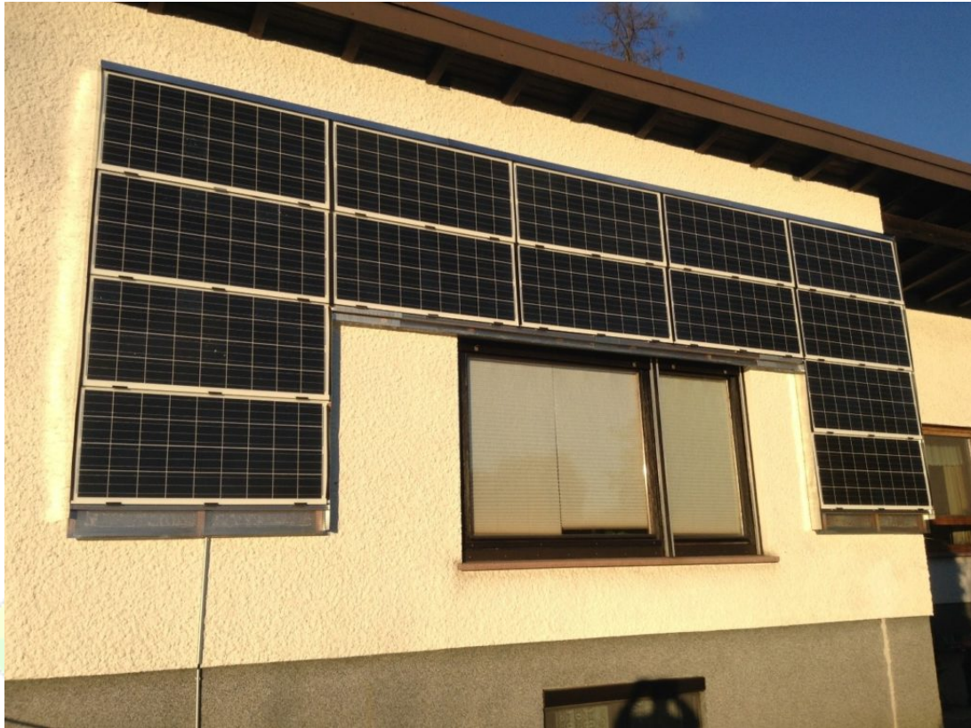
Fassaden-Photovoltaik-Anlage mit 10 Zentimetern Hinterlüftung zur Hauswand und einer Ausrichtung von 180 Grad. Diese Aufnahme entstand im Dezember Foto: Thomas Vorderwülbecke
